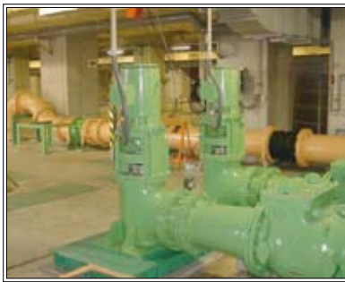
水処理センター (担体投入型高度生物処理法)
